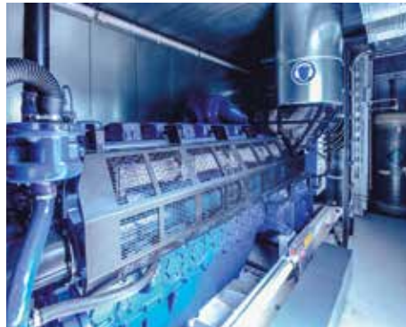
Der Notfallgenerator besteht aus einem VW-Dieselmotor und wird mit Öl betrieben.
